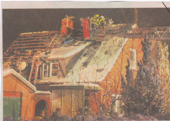
Feuerwehrleute am Einfamilienhaus im Einsatz.
