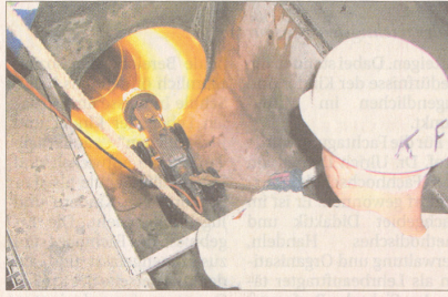
Alle Abwasserrohre auf privatem Grund müssen bis spätestens 31. Dezember 2015 „durchleuchtet“ werden. Die Kosten zahlt der Hausbesitzer. Foto: Paul-Georg Meister/pixelio
