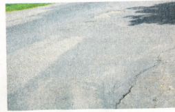
Nur scheinbar harmlos: Die Schäden am Schäferdresch könnten rasch zunehmen
